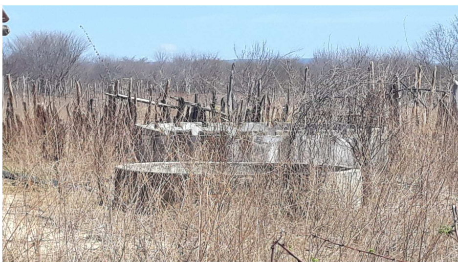
Cisternas em ruínas
