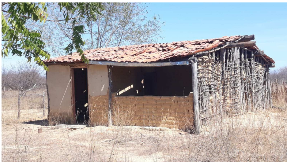
Casa em abandono (ruínas)
